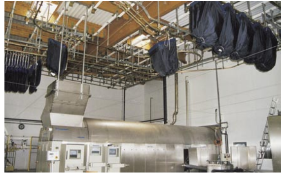
Section lavage : tunnel de lavage et convoyeur de linge sale.
