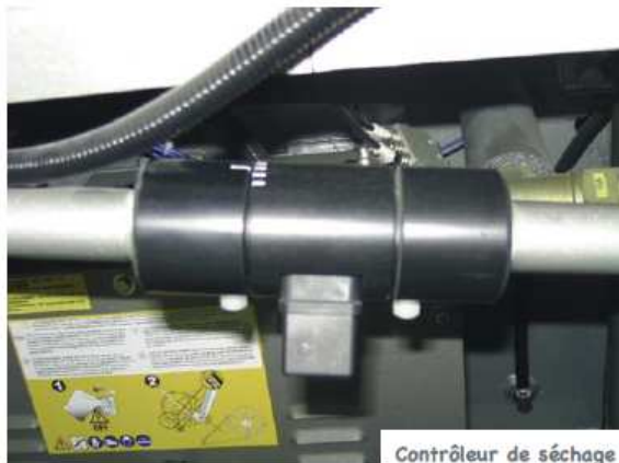
Contrôleur de séchage
